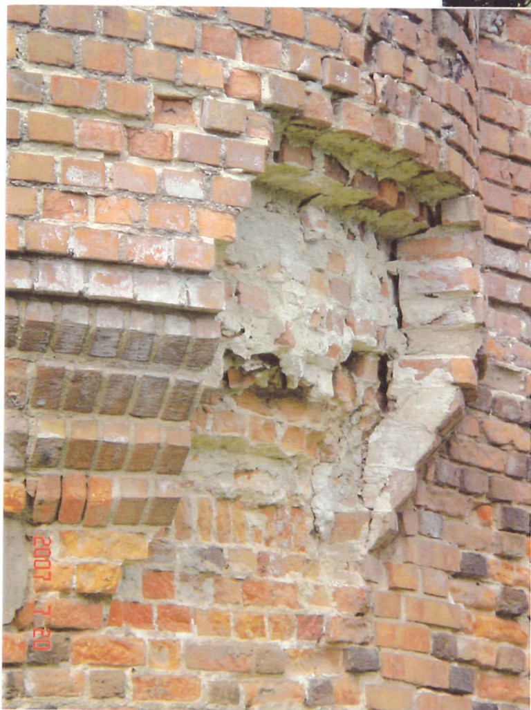
fot.30. Basteja południowo-zachodnia – ściana południowa. Widoczny odspojony fragment przewieszzonego muru, grożący spadnięciem.
