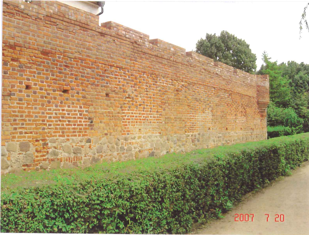
fot.5. Mur zachodni w widoku od strony zewnętrznej. W głębi basteja południowo-zachodnia, w której nastąpiła awaria muru.
