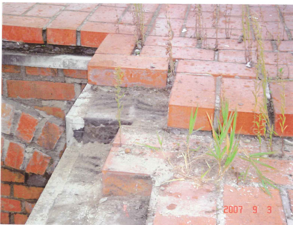
fot.22. Basteja południowo-zachodnia – fragment schodów. Widoczne porosty trawą w spoinach posadzki i skorodowana nie wiążąca cegiel zaprawa. Cegły położone na warstwie zaprawy cementowej, pod którą jest izolacja z papy. Na zdjęciu widać papę położoną w spadku w kierunku przeciwnym do założonego kierunku spływu wody na dziedziniec.
