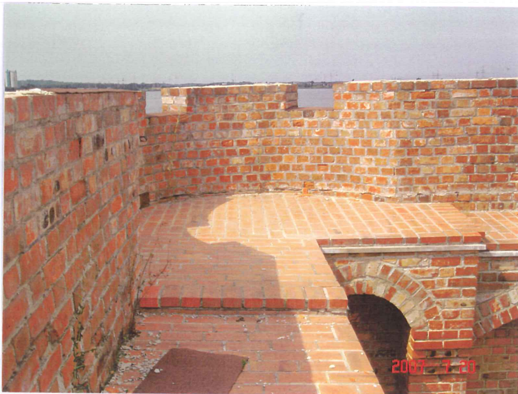
fot.17. Basteja północno-zachodnia zachowana w dobrym stanie. Widoczny chodnik obronny w spadku, zarówno w murach jak i w bastei. Po lewej stronie widoczne porosty trawą świadczące o szczelinie między murem, a posadzką chodnika.
