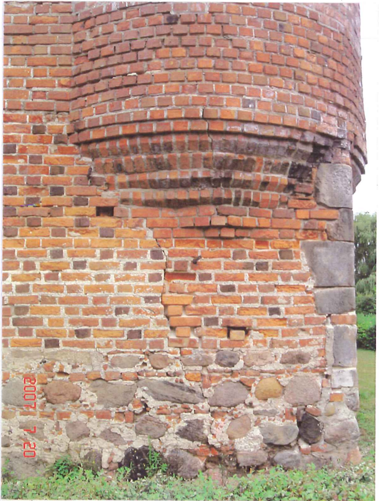
fot.25. Basteja południowo-zachodnia – widok od strony zachodniej. W murze poniżej przewieszenia widoczne ukośne pęknięcia, ubytek muru wypełniony współcześnie ceglami.
