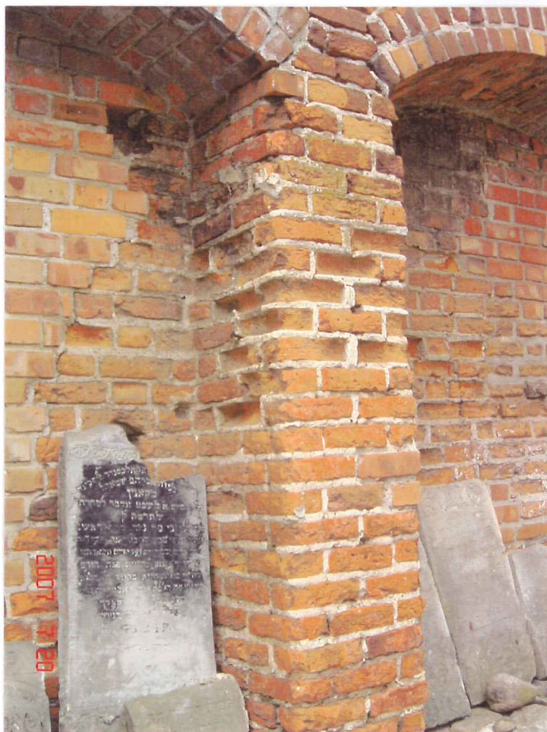
fot.12. Mur arkadowy północny. Widoczne głęboko skorodowane cegły z głębokimi ubytkami. Po lewej stronie na murze ukośne pęknięcie.
