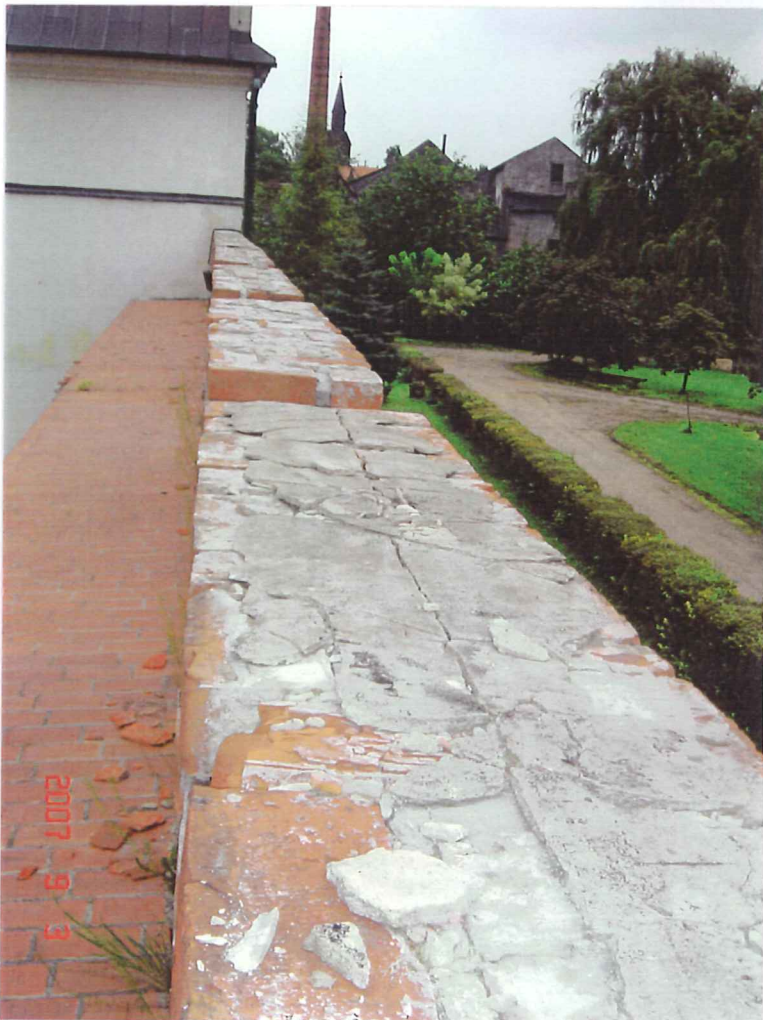
fot.14. Korona muru południowego. Na koronie gładź cementowa spękana, odspojona od muru, ze znacznymi ubytkami.
