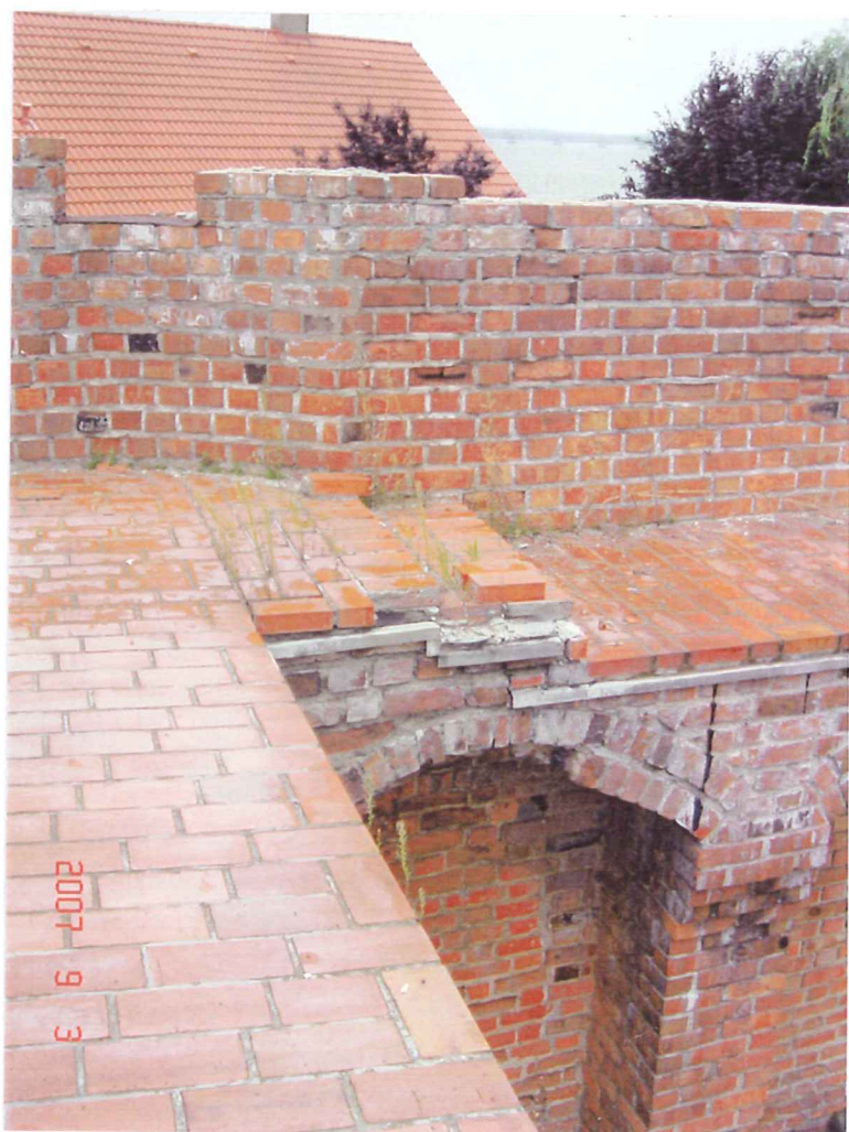
fot.20. Basteja południowo-zachodnia. Widoczne liczne porosty trawą na chodniku. Na murach fragmenty zasoleń i wypłukanego węgla wapnia.
