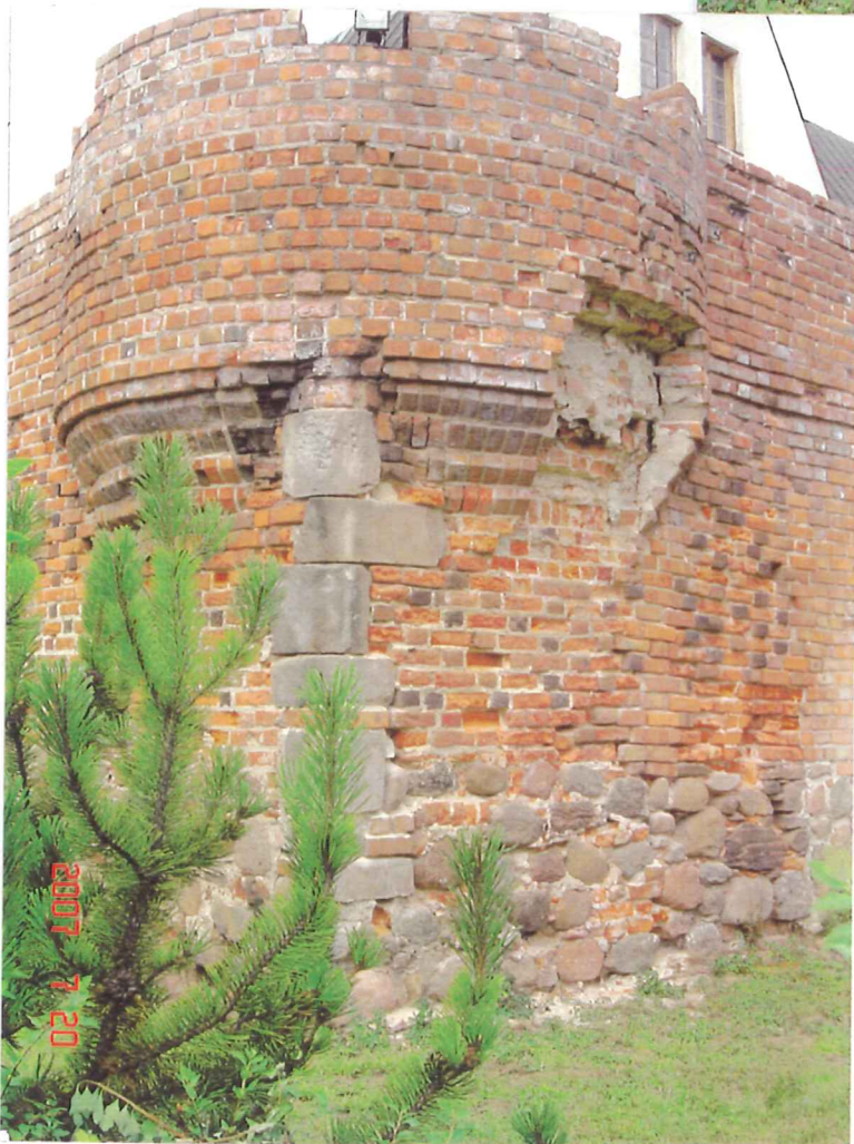
fot.26. Basteja południowo-zachodnia – widok od strony naroża. Po prawej stronie widoczny znaczny ubytek muru, który runął wiosną 2007r.
