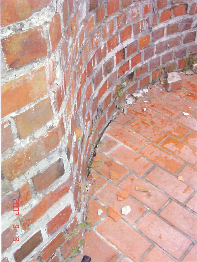
fot.23. Basteja południowo-zachodnia. Widoczna szczelina o znacznej szerokości między murem a posadzką chodnika.
