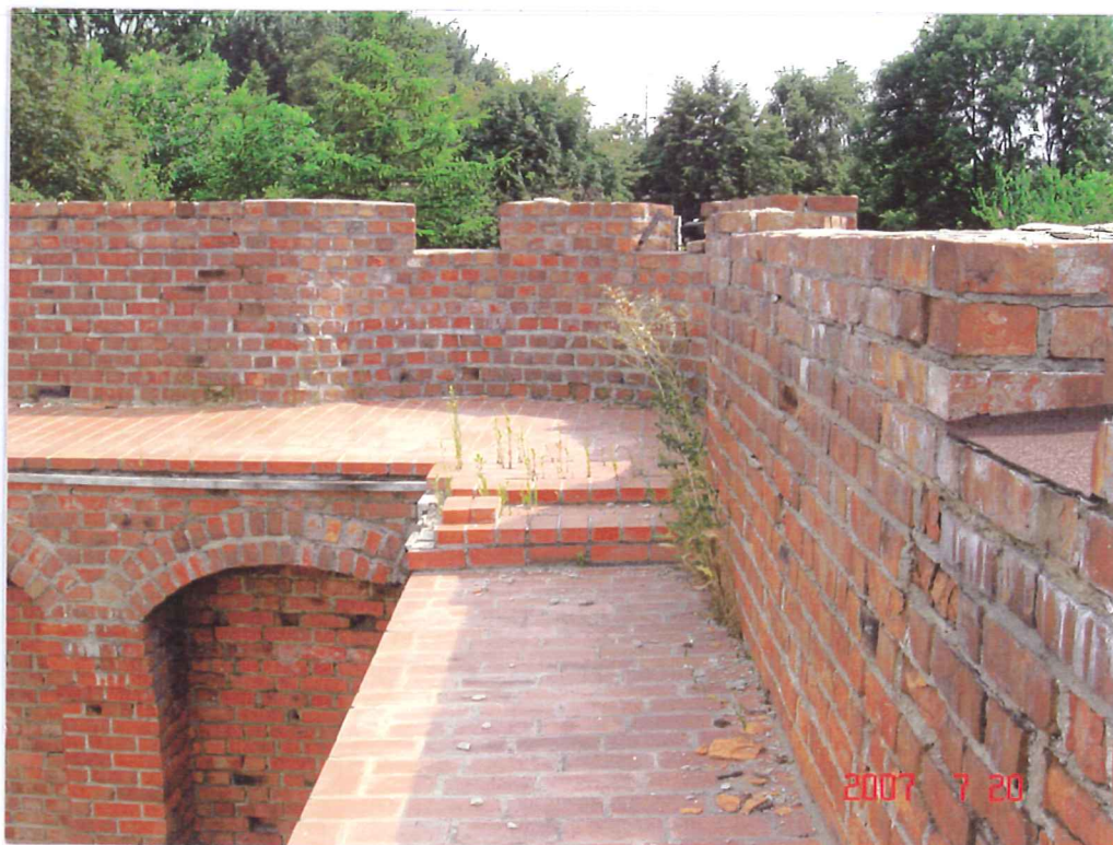
fot.19. Basteja południowo-zachodnia w której nastąpiła awaria muru południowego. Chodnik obronny i schody wyłożone współczesną cegłą. Chodniki w murach w spadku w kierunku dziedzińca, w bastei spadek w kierunku muru. Widoczne liczne porosty trawą, świadczące o szczelinach między murem a posadzką chodnika oraz o szczelinach w posadzce.
