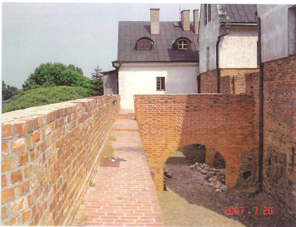
fol.10. Mur północny – widoczna korona muru i chodnik obronny. W głębi mur poprzeczny. Po prawej stronie i w głębi zamek. Chodnik o posadzce ze współczesnej cegły położonej w spadku.
