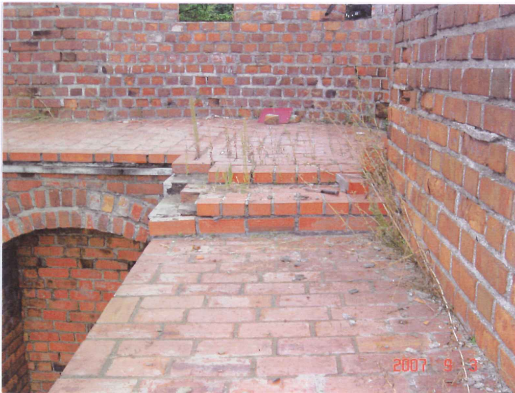
fot.21. Basteja południowo-zachodnia. Widoczny spadek posadzki chodnika w bastei w kierunku ściany otaczającej chodnik. Na pierwszym planie schody z licznymi porostami w spoinach.
