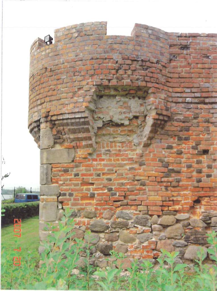
fot.27. Basteja południowo-zachodnia – widok od strony południowej. Widoczny znaczny ubytek muru w części przewieszanej. Fragment muru który runął odsłonił kotwę stalową. Dołem w murze liczne cegły głęboko skorodowane z ubytkami. Zaprawa skorodowana z głębokimi ubytkami. Szczególnie głębokie ubytki zaprawy występują przy blokach kamiennych naroża.
