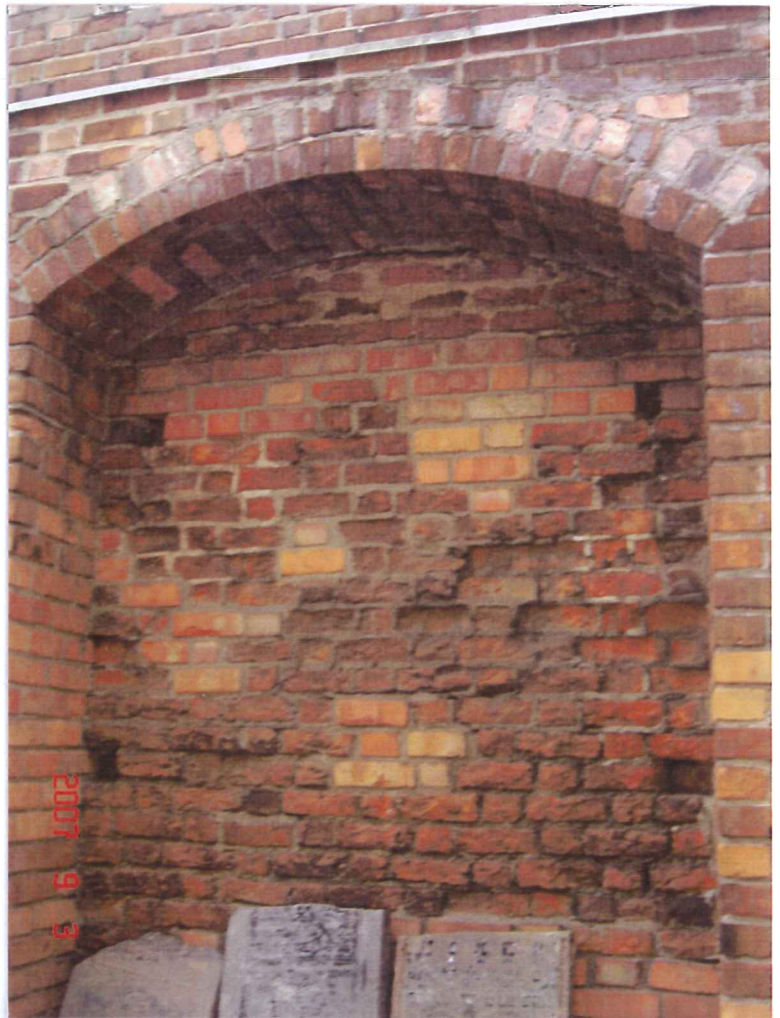
fot.13. Mur arkadowy północny. Widoczne głęboko skorodowane cegły z głębokimi ubytkami.
