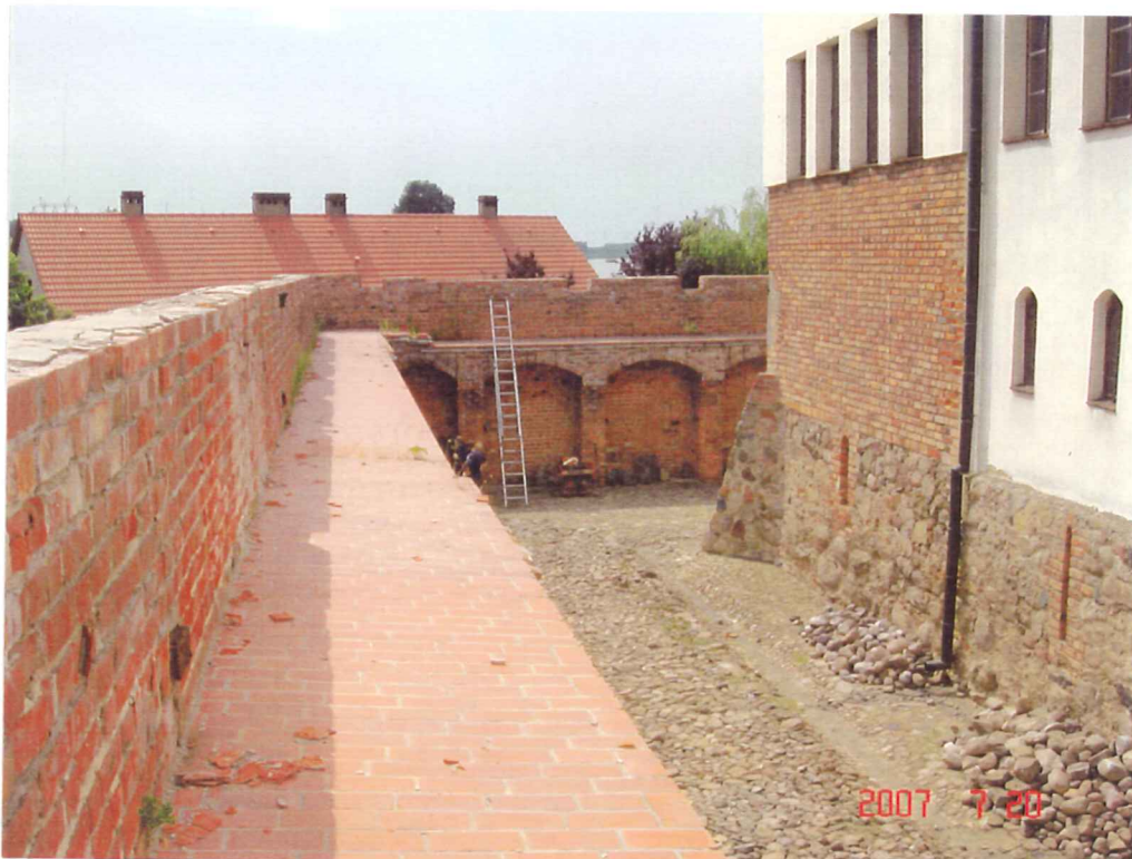
fot.4. Mur południowy – widoczna korona muru i chodnik obronny. W głębi w narożu murów basteja południowo-zachodnia, w której nastąpiła awaria muru. Chodnik obronny o posadce ze współczesnej cegły, położonej w spadku.
