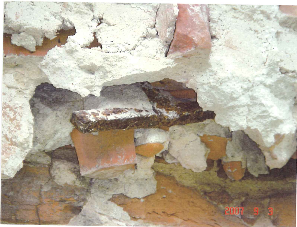
fot.28. Basteja południowo-zachodnia – zbliżenie w miejscu z którego oderwała się część przewieszanego muru. Widoczna skorodowana kotwa stalowa.
