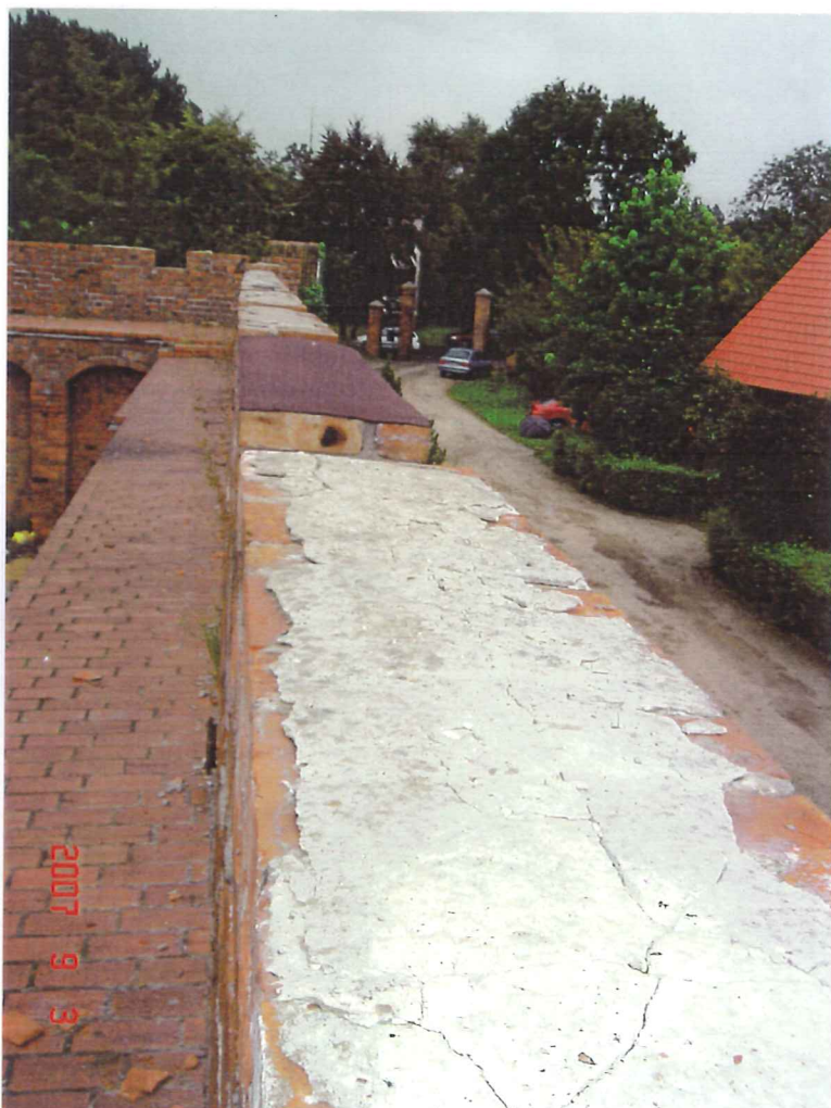
fot.16. Korona muru zachodniego. Na koronie gładź cementowa spękana z ubytkami. W głębi zachowany fragment pokrycia korony muru papą.
