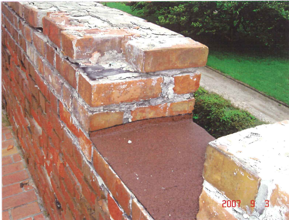
fot.15. Fragment korony muru zachodniego. Na koronie gładź cementowa spękana z ubytkami. We wnętrzu krenelażu na gładzi warstwa papy asfaltowej z posypką, klejona lepikiem smołowym. Na koronie muru pod górną warstwą cegły jest założona izolacja folią.
