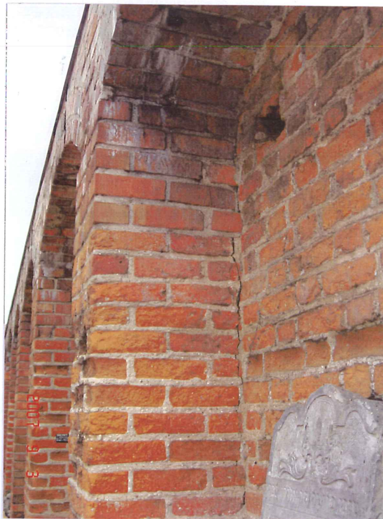
fot.11. Mur arkadowy zachodni. Widoczne pęknięcie między filarem a murem.
