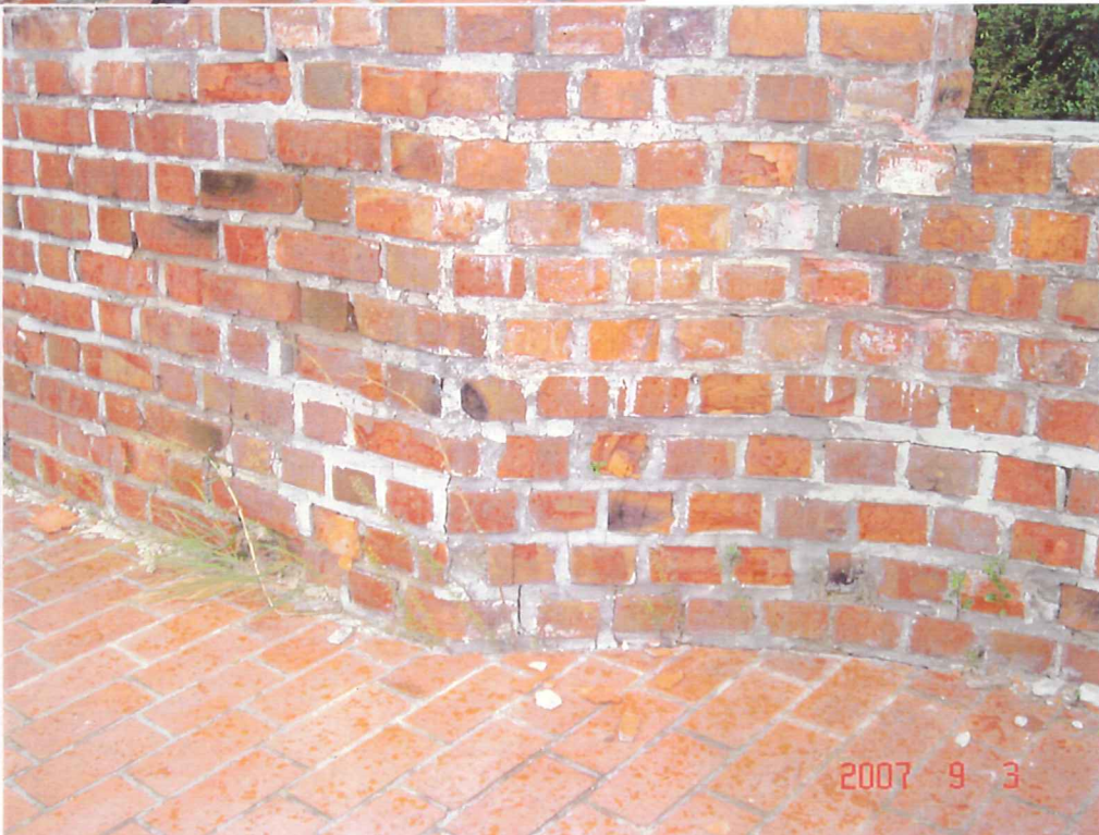
fot.24. Basteja południowo-zachodnia. Widoczne pionowe zarysowania w murze bastei, o niewielkiej rozwartości. Na ceglach ślady wycieku węglanu wapnia.
