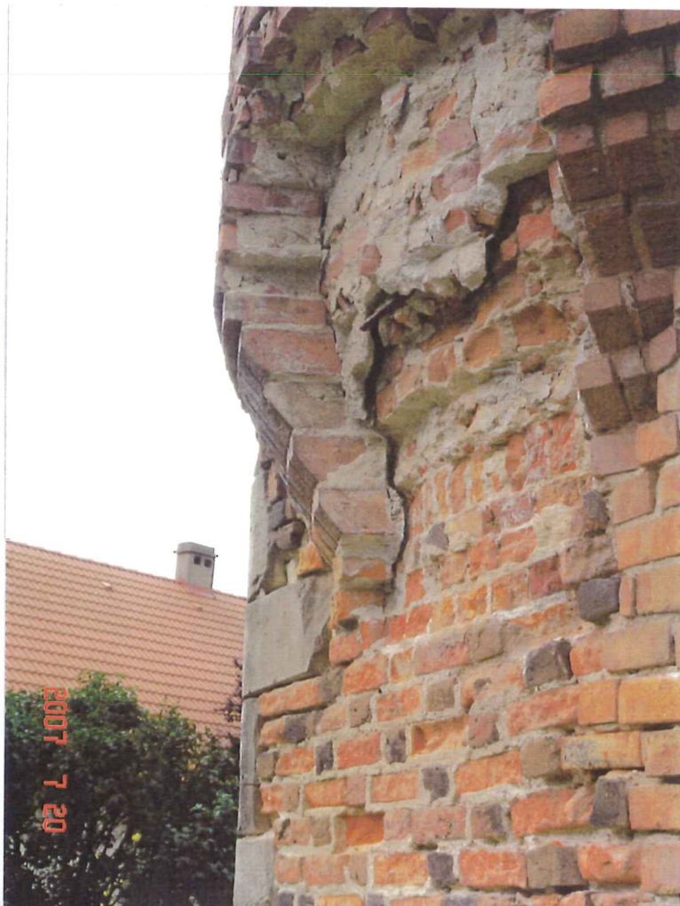
fot.29. Basteja południowo-zachodnia – ściana południowa. Widoczny odspojony fragment przewieszzonego muru, grożący spadnięciem.
