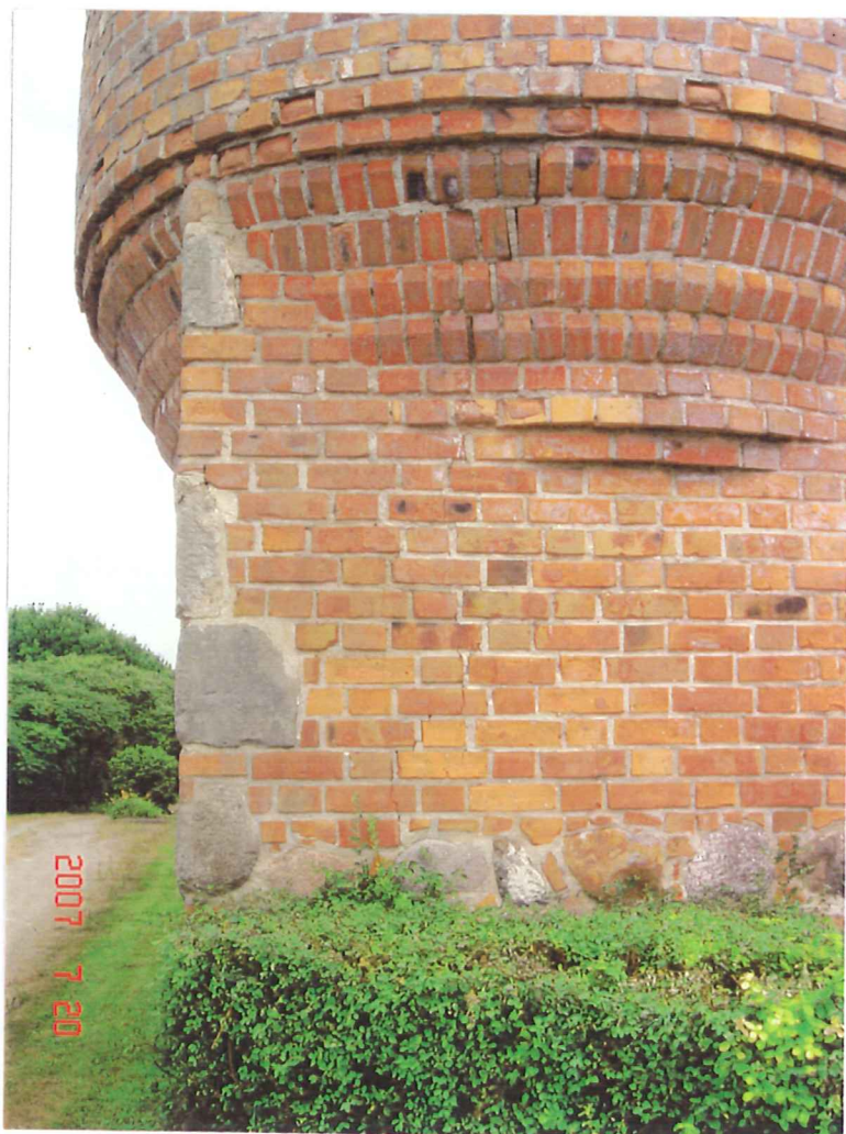
fot.18. Basteja północno-zachodnia. W części górnej wspornikowo wysuniętej bastei oraz w murze dolnym widoczne ukośne pęknięcia.
