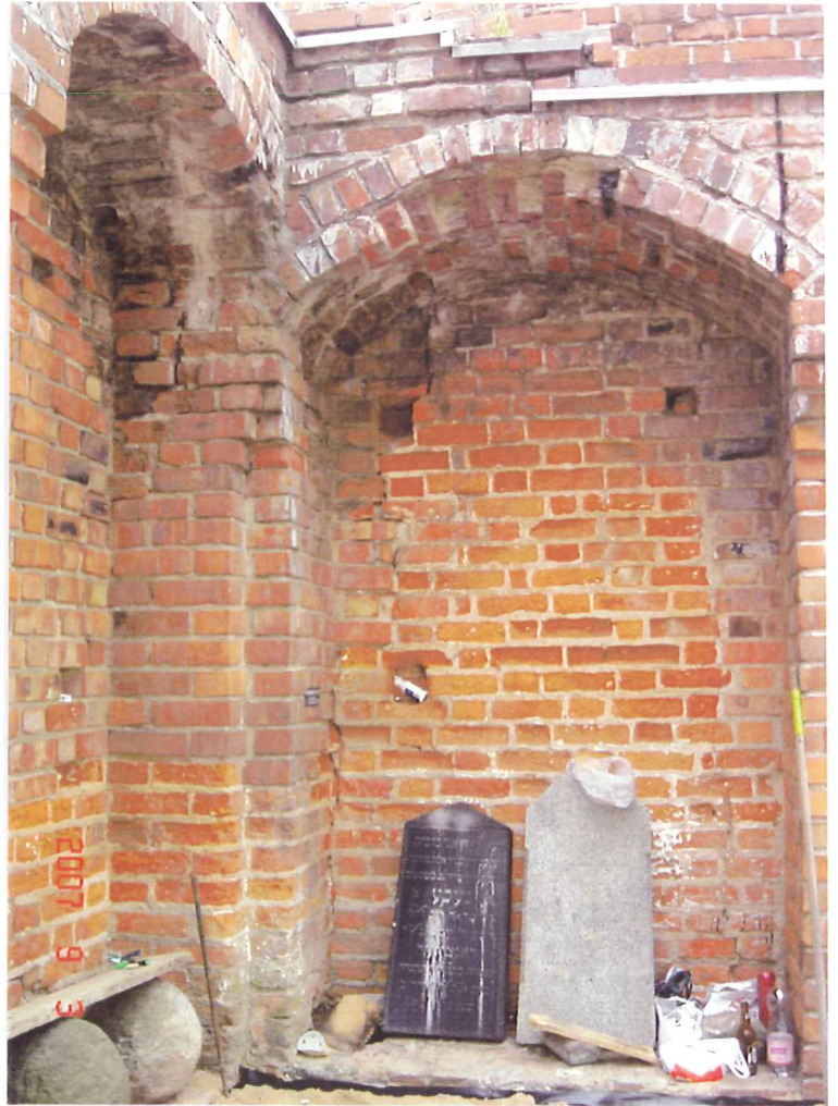
fot.31. Naroże ścian arkadowych pod basteją południowo-zachodnią. Górą na murach widoczne zasolenia i osady węgla wapnia oraz silne zawilgocenia. Pionowe pęknięcia w ścianie zachodniej wzdłuż filara narożnego.
