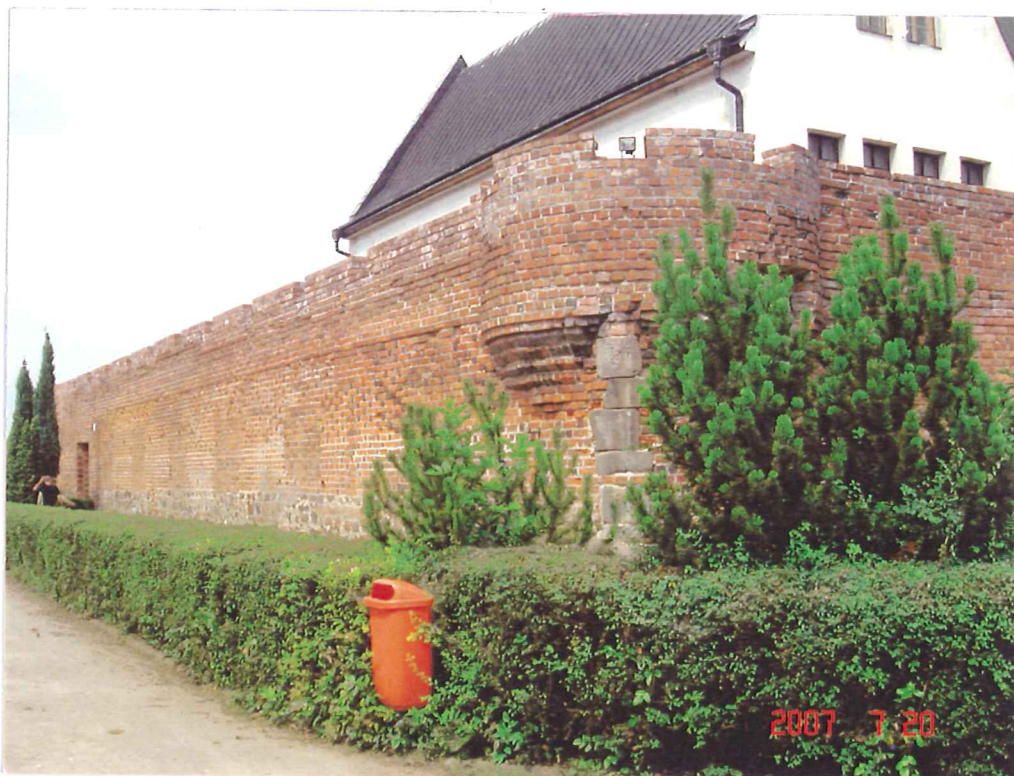
fot.1. Widok ogólny muru obronnego od strony południowo-zachodniej. Na pierwszym planie na narożu murów basteja, w której nastąpiła awaria muru.
