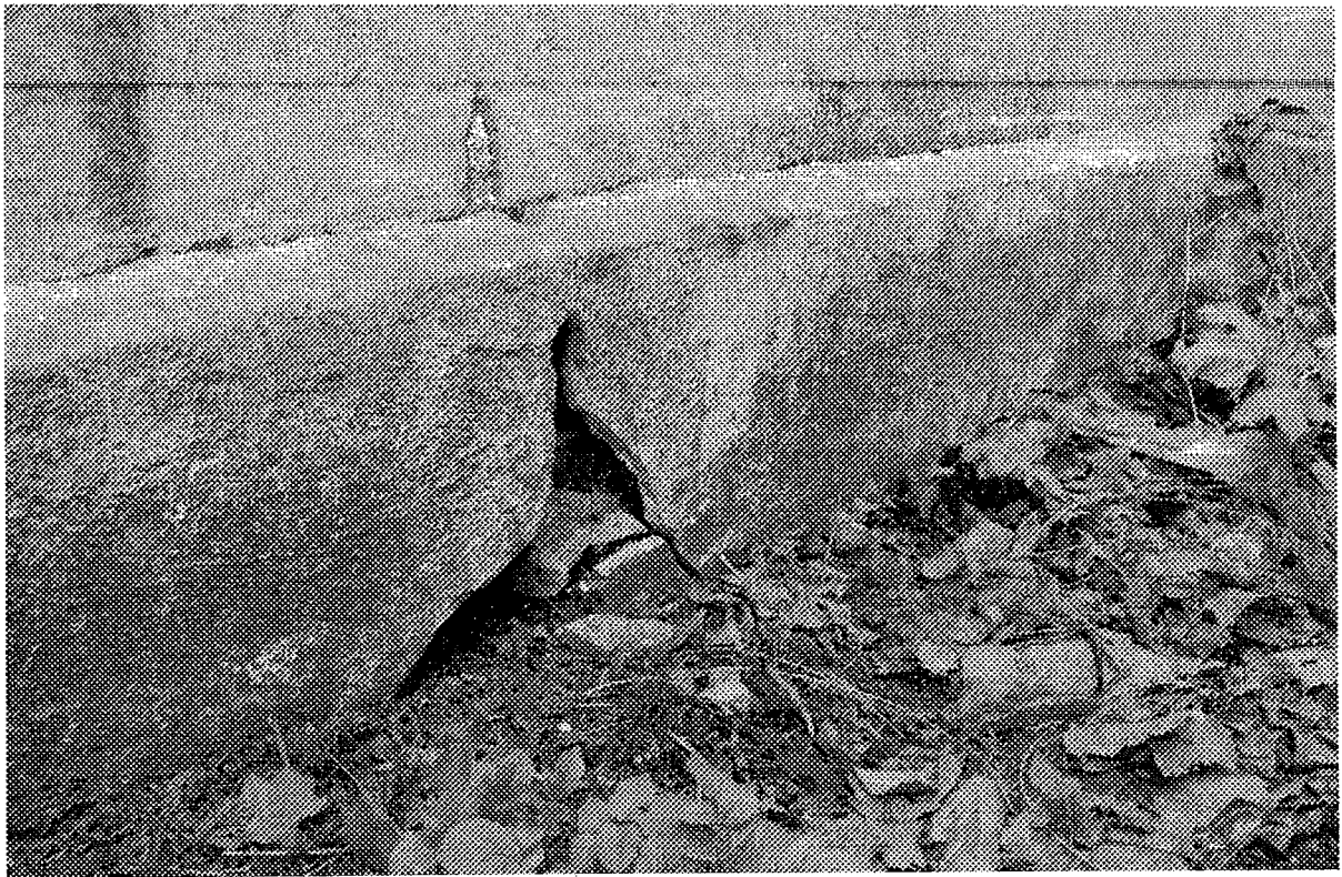
W miejscu uszkodzenia widoczna jest przestrzeń wentylująca między odsadzką a murem
