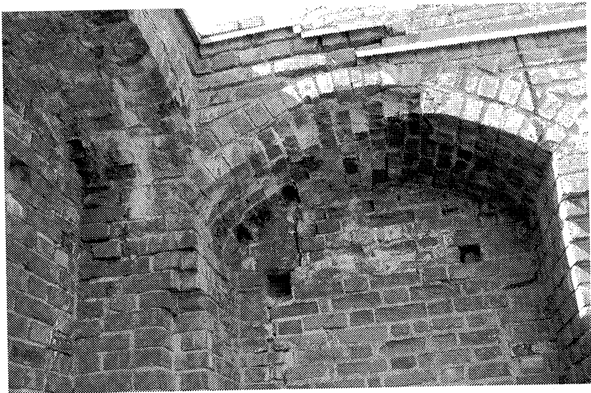
Widok pękniętej bastei od strony dziedzińca
