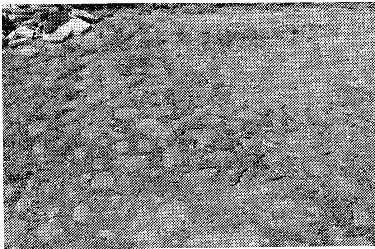
Uszczelnienie dziedzińców uniemożliwia prawidłowe parowanie wody i zwiększa przez to zawilgocenie murów
