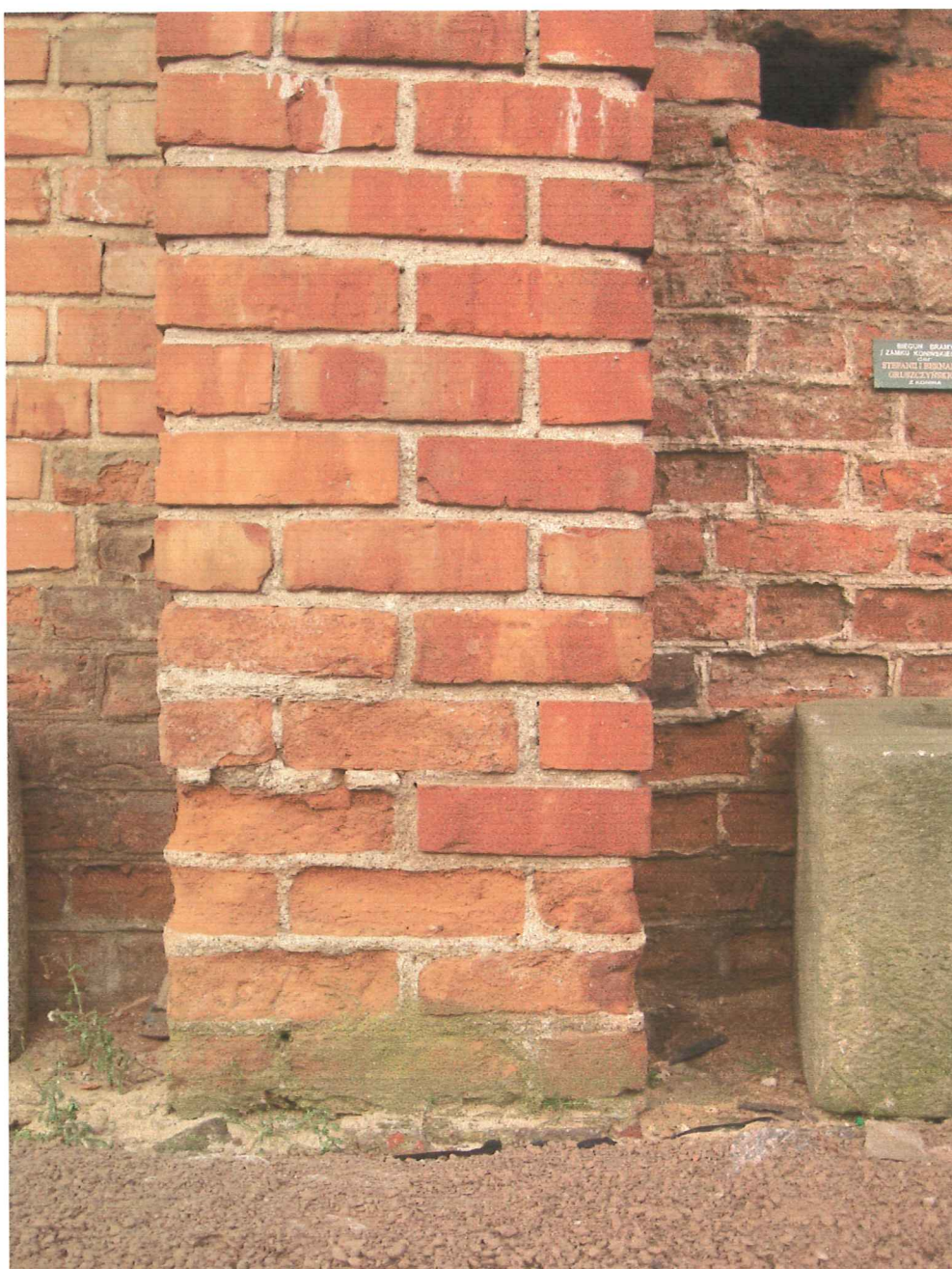
Fot 19. Zamek w Koninie - mur obwodowy – część wewnętrzna. Widoczne znaczne zniszczenia wątku ceglanego w dolnej partii również w miejscu wykonanych wcześniej przemurowań wątku, glony na powierzchni cegieł, powierzchnia części wątku zatarta zaprawą.
