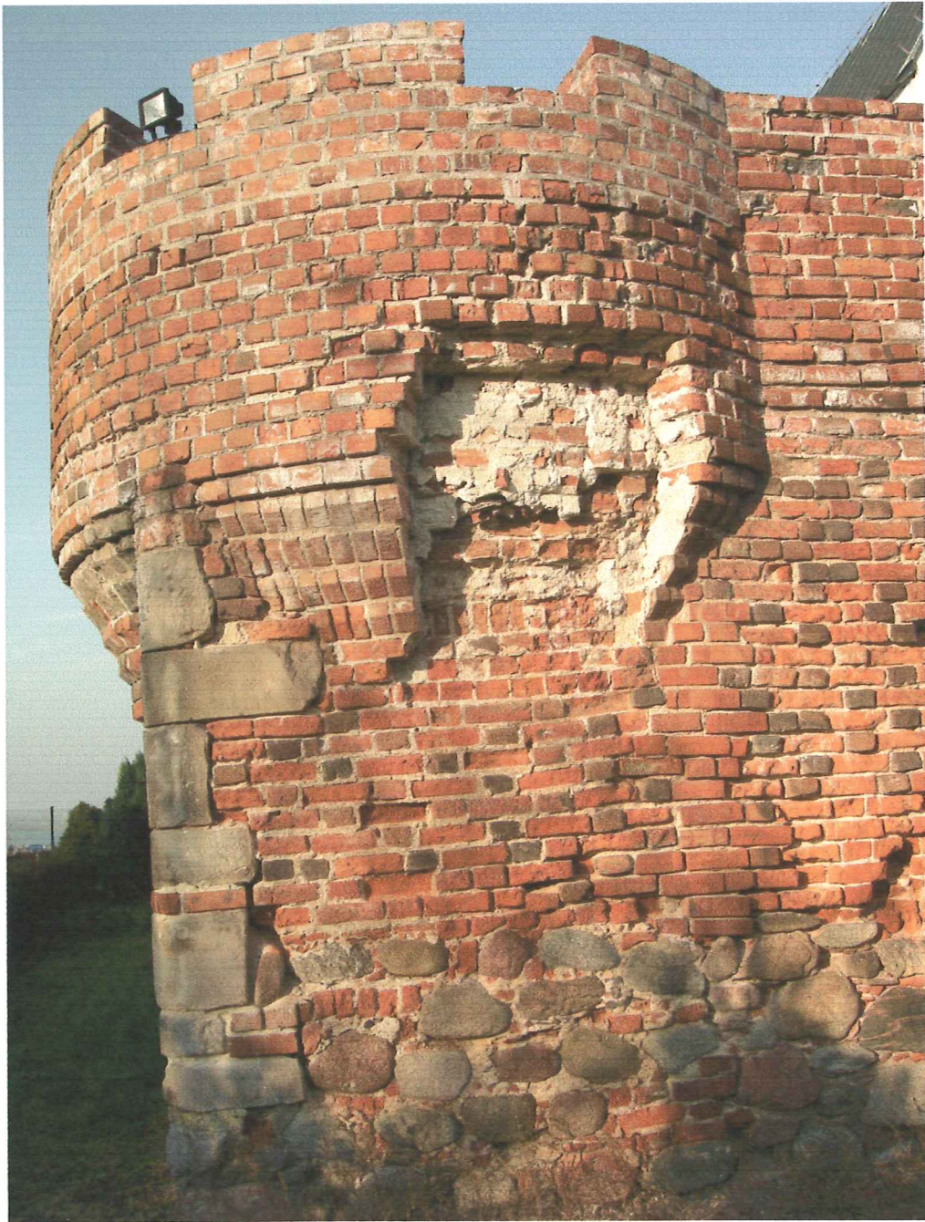
Fot 2. Zamek w Koninie - mur obwodowy – część zewnętrzna. Wieżyczka narożna. Widoczne przemurowania, duży ubytek wątku ceglanego, zabielenia i zniszczenia powierzchni cegieł osłabione i osypujące się partie spoinowania.
