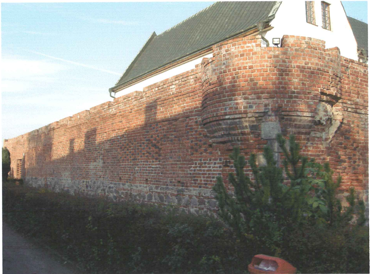
Fot 1. Zamek w Koninie - mur obwodowy. Widok ogólny – część zewnętrzna. Widoczne liczne przemurowania. Zabielenie cegieł w partii krenelażu, duży ubytek na wieżyczce narożnej.
