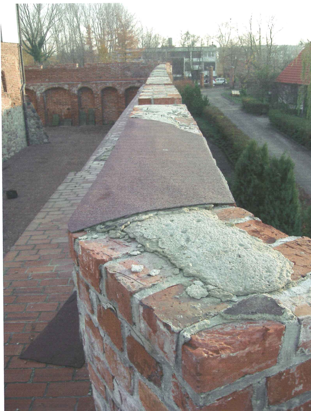
Fot 11. Zamek w Koninie - mur obwodowy – część wewnętrzna. Widoczna górna część krenelażu z resztką papy która miała chronić powierzchnię cegieł przed opadami atmosferycznymi oraz resztki zaprawy na której położono papę. Widać również zniszczenia cegieł, ich zabielenie i złuszczenie się powierzchni.
