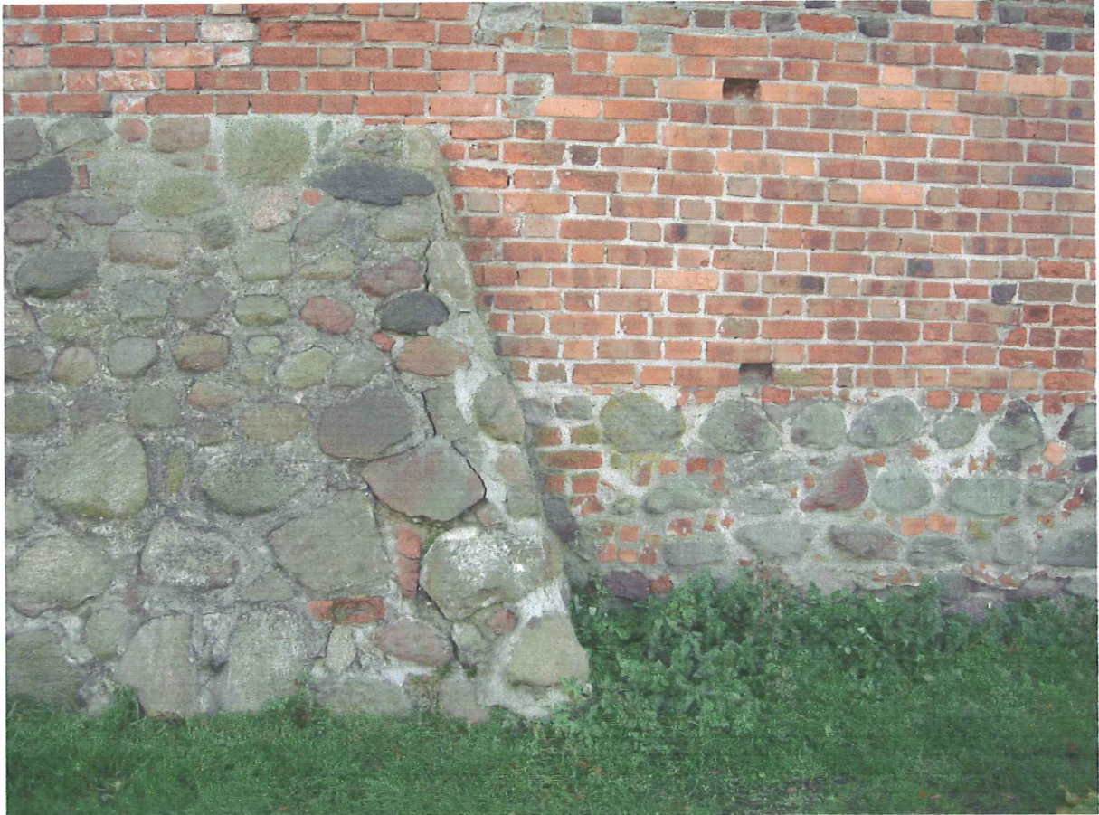
Fot 5. Zamek w Koninie - mur obwodowy – część zewnętrzna. Widoczna szkarpa kamienna oraz część cokołowa muru w znaczącej części wykonana z kamienia. Na szkarpie widoczne duże biegnące pionowo pęknięcie przy narożniku, glony na powierzchni wątku, zabielenia powierzchni pojedynczych cegieł oraz ubytki lica.
