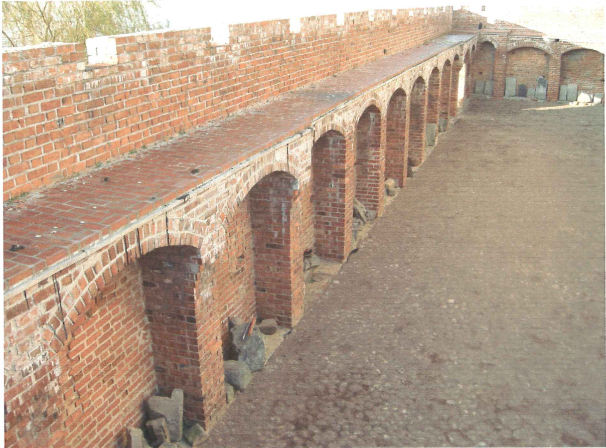
Fot 9. Zamek w Koninie - mur obwodowy – część wewnętrzna. Widok ogólny. Widoczna ceramiczna posadzka na murze, zabielenia cegieł w partii krenelażu i łuków arkad, na posadzce widoczne osypane fragmenty cegieł i spoinowania.
