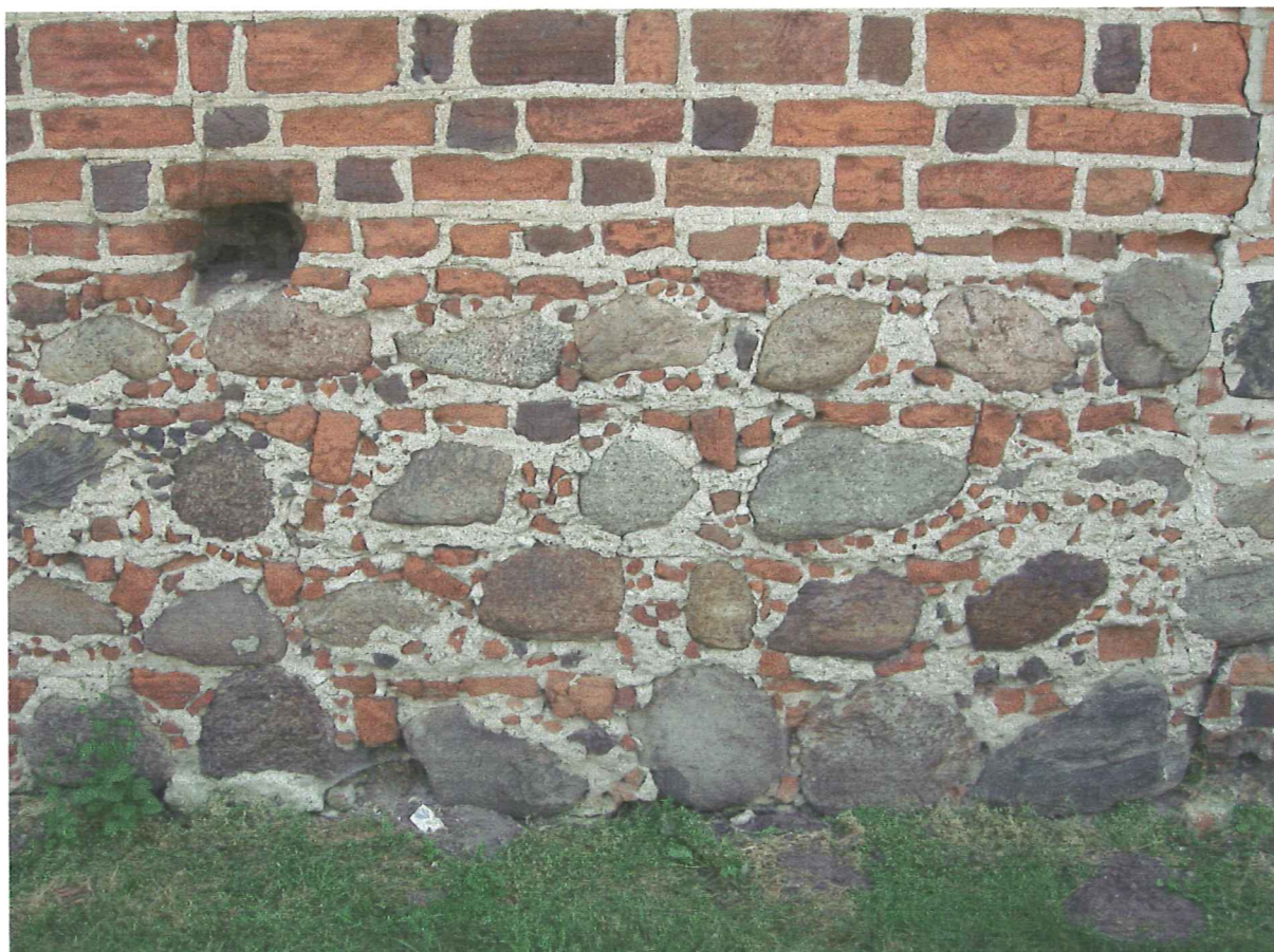
Fot 6. Zamek w Koninie - mur obwodowy – część zewnętrzna. Widoczna część cokołowa muru w znaczącej części wykonana z kamienia, powyżej widoczne zniszczenia wstępu przejawiające się w pudrowaniu i osypywaniu cegieł oraz miejscowym wykruszeniu spoinowania, pęknięcie muru.
