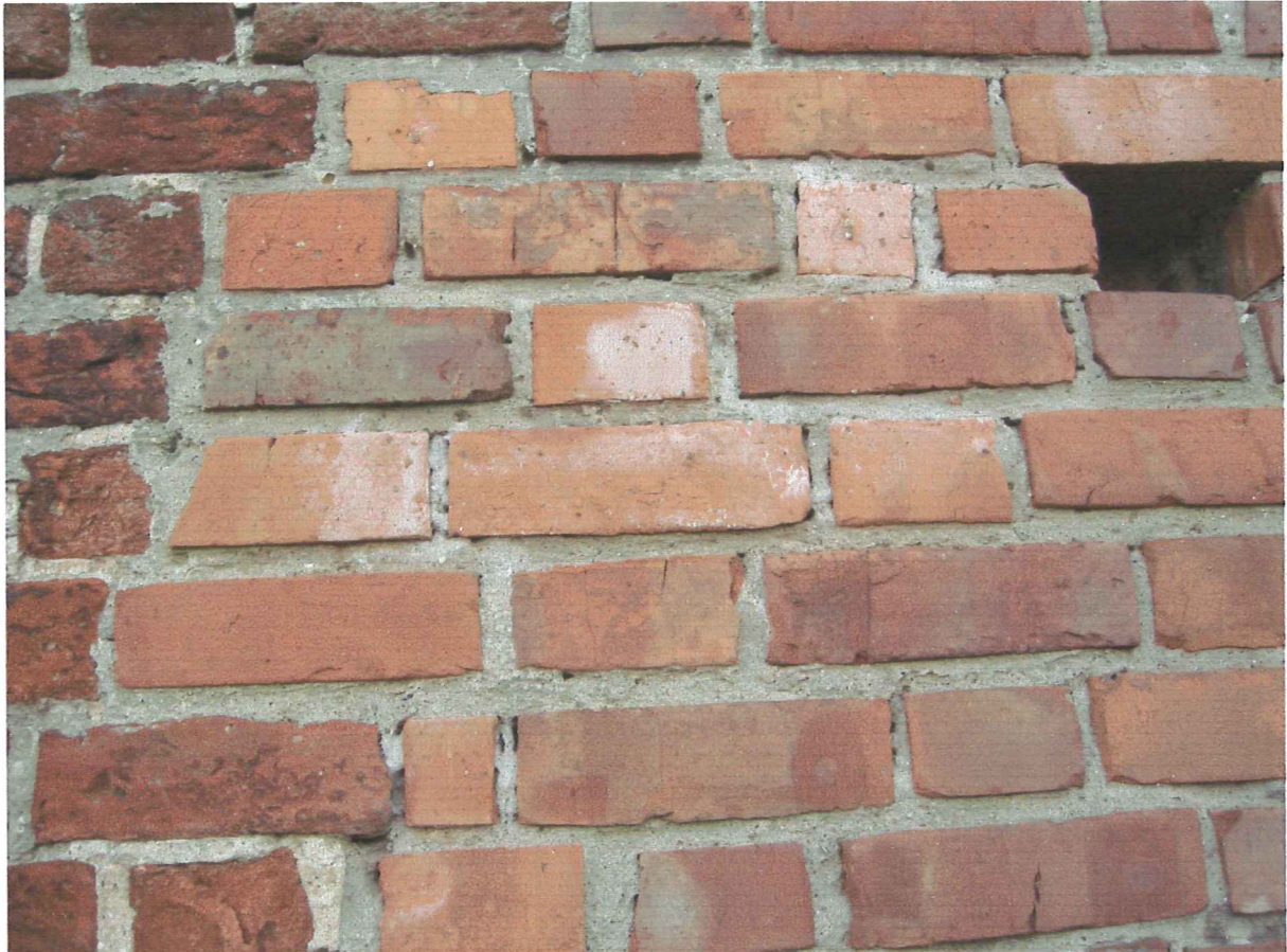
Fot 8. Zamek w Koninie - mur obwodowy – część zewnętrzna. Widoczny fragment jednego z licznych przemurowań. Cegły kładzione na mocnej zaprawie cementowej. Zabielenia na powierzchni cegieł to prawdopodobnie sole.
