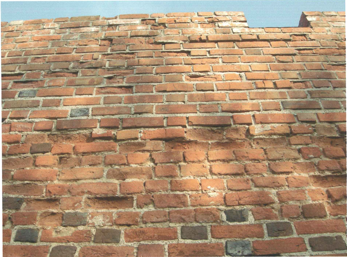
Fot 4. Zamek w Koninie - mur obwodowy. Widoczne znaczne zniszczenie wątku ceglanego, złuszczenie i pudrowanie się cegły miejscami na dużą głębokość, osypujące się partie spoinowania, zatarcia zaprawą na powierzchni cegły.
