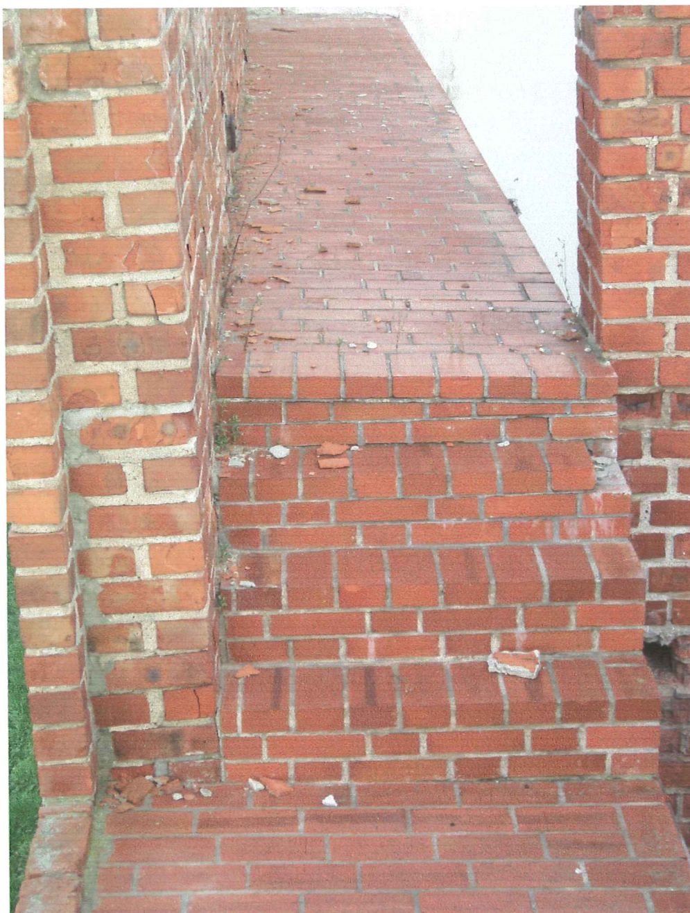
Fot 10. Zamek w Koninie - mur obwodowy – część wewnętrzna. Widoczna część posadzki ceramicznej na murze, zniszczenia cegieł pękających i złuszczających się dużymi kawałkami oraz nieszczelności spoinowania w obrębie posadzki, odpadanie cegieł (stopień).
