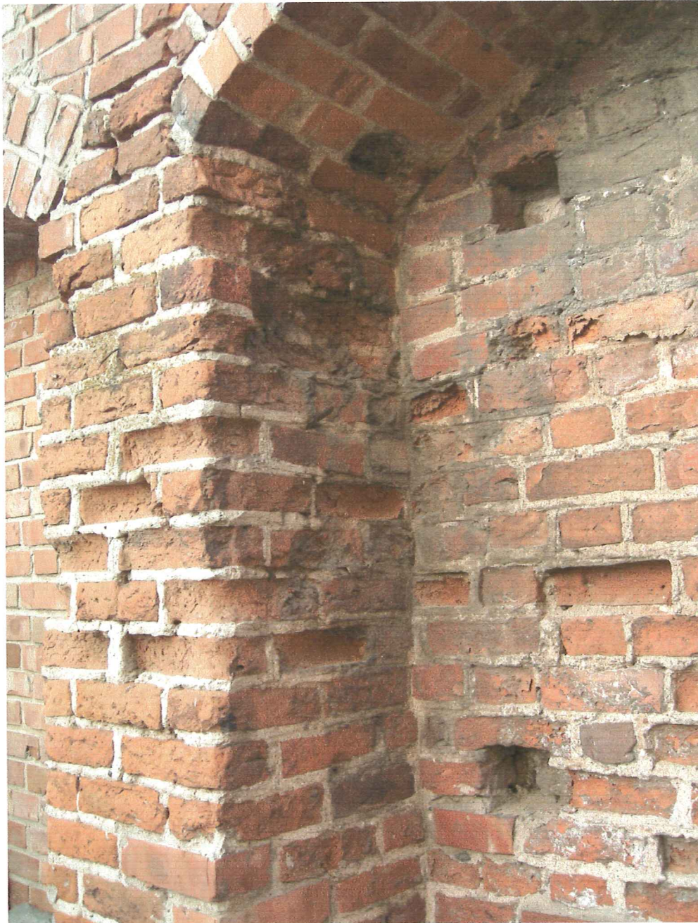
Fot 17. Zamek w Koninie - mur obwodowy – część wewnętrzna. Fragment arkady. Widoczne znaczne zniszczenia wstępu ceglanego, osłabienie i wykruszanie się cegieł, na dużą głębokość, miejscowe ubytki w partii spoinowania.
