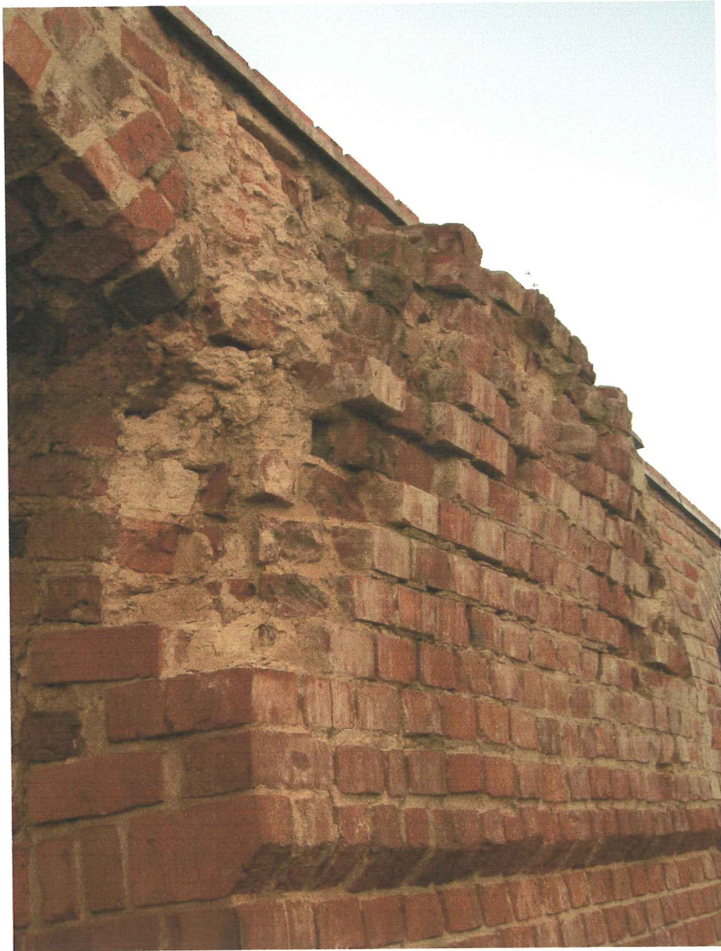
Fot 15. Zamek w Koninie - mur obwodowy – część wewnętrzna. Fragment łuku pomiędzy murem a ścianą budynku. Widoczne zniszczenia wstęgu ceglanego, zabielenia na powierzchni cegieł, osłabienie i wykruszanie się spoinowania.
