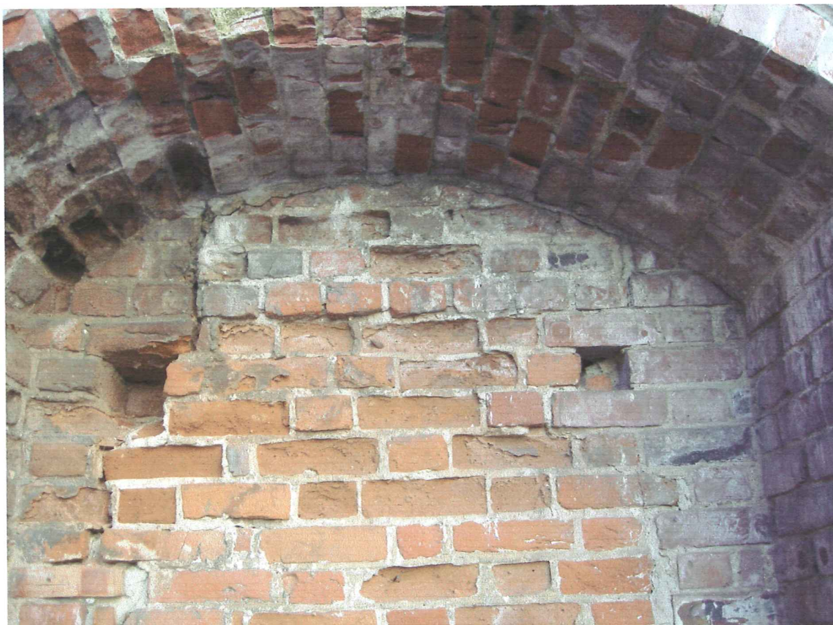
Fot 16. Zamek w Koninie - mur obwodowy – część wewnętrzna. Fragment arkady. Widoczne znaczne zniszczenia wstępu ceglanoego, zabrudzenia, zabielenia na powierzchni cegieł, osłabienie, pudrowanie i złuszczenie się wierzchnich warstw cegieł, oraz pęknięcia muru, na łuku arkady miejscowo widoczne glony.
