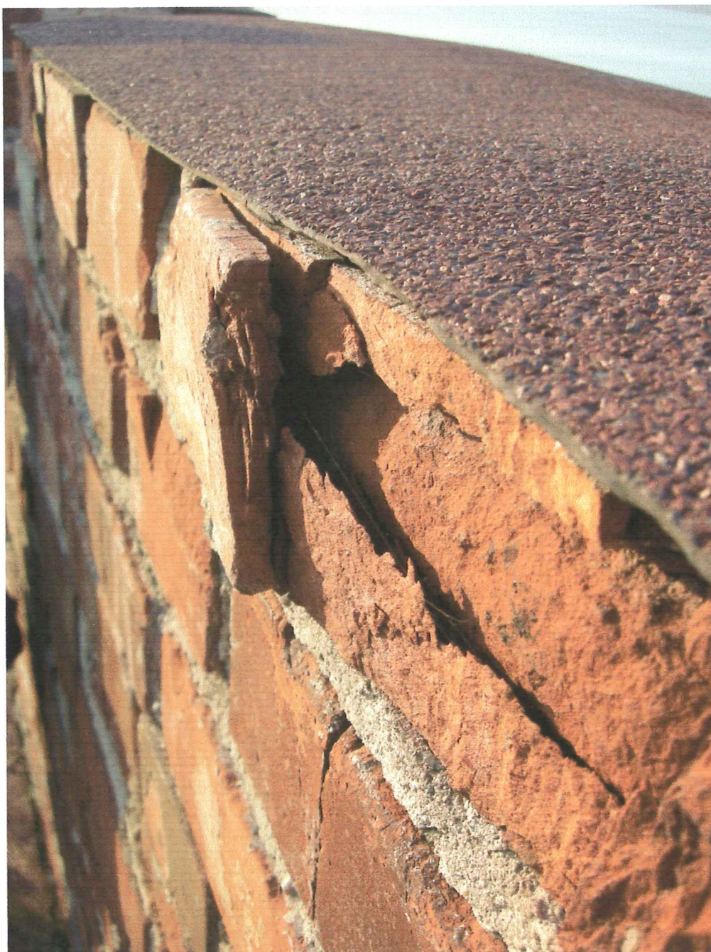
Fot 12. Zamek w Koninie - mur obwodowy – część wewnętrzna. Fragment krenelażu. Widoczne znaczne zniszczenia cegieł pod warstwą papy która miała chronić powierzchnię cegieł przed opadami atmosferycznymi, zluszczenie całych płatów cegły sięgające na dużą głębokość i prowadzące do całkowitego jej rozpadu.
