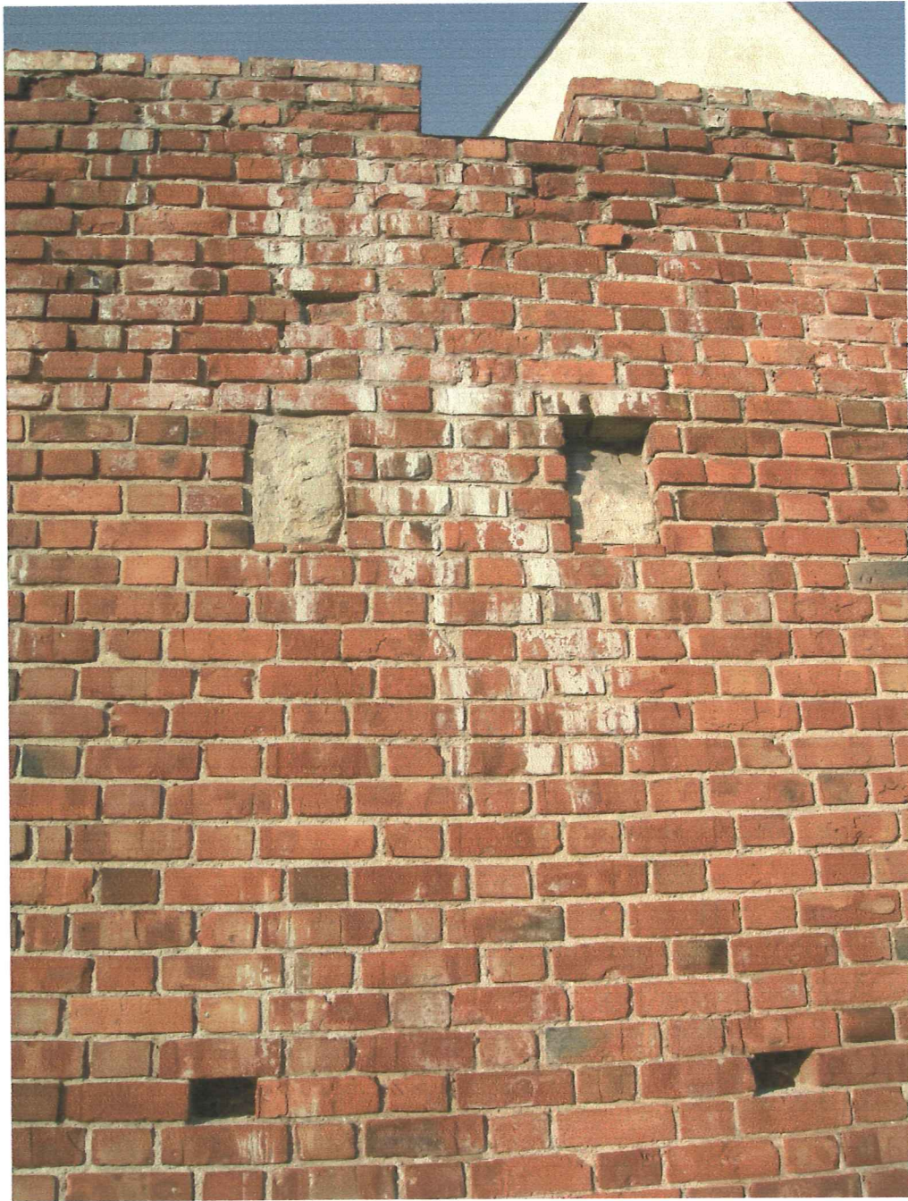
Fot 3. Zamek w Koninie - mur obwodowy – część zewnętrzna. Widoczne zabielenia i zniszczenia powierzchni cegieł osłabione i osypujące się partie spoinowania, białe zacieki na powierzchni wątku (węglan wapnia lub sole).
